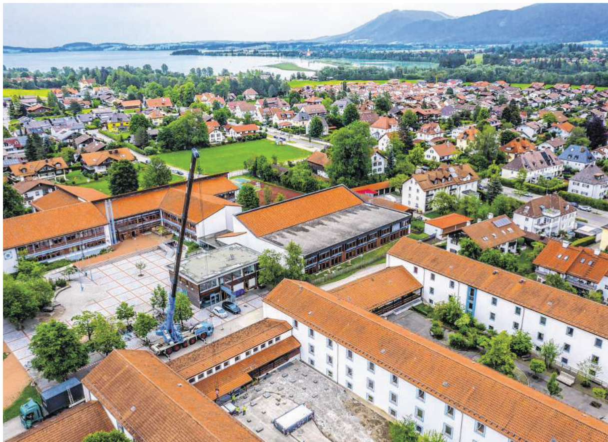
Ein Autokran hievte am Mittwochvormittag erste Bauteile für einen zweistöckigen Container-Trakt in den Innenhof der Anton-Sturm-Mittelschule. Bis Mitte Juli soll die Schulverwaltung umgezogen sein. Der bisherige Büroteil wird dann abgerissen.
